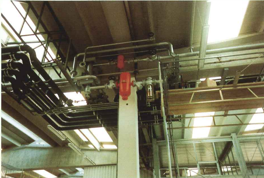
Impianto trasporto vapore industria conserviera di marmellate Monselice (PD) Pressione: 12/3 bar Portata: 12 ton./h
