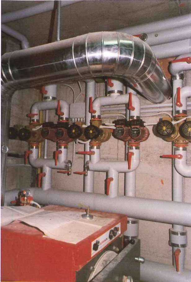
Impianti idro termo sanitari per Istituto Bancario - PADOVA Potenza termica risc. 200 kW Potenza frigorif. 50kW
