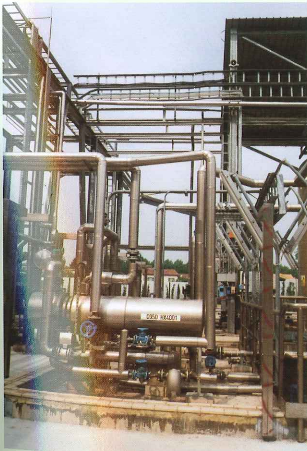
Impianto per lo stoccaggio e la diluizione acido solforico Castelmassa (RO) Portata: 60 m 3 /h (4%) Capacità stoccaggio 60m 3
