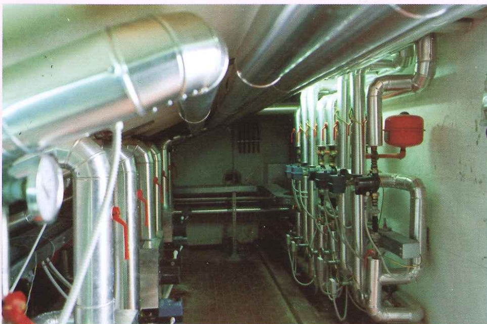
Impianti idro termo sanitari centro commerciale Monselice (PD) Potenza termica risc. 300 kW Potenza frigorif. 100kW
